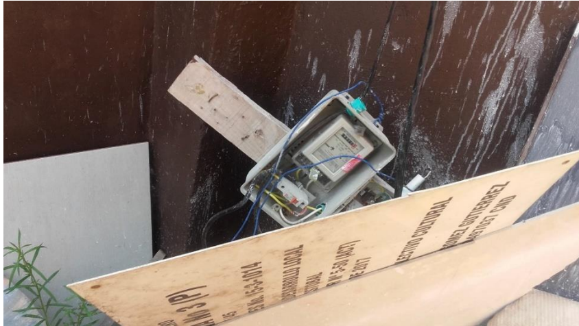
Foto N° 13 Contador de energía sin instalar
