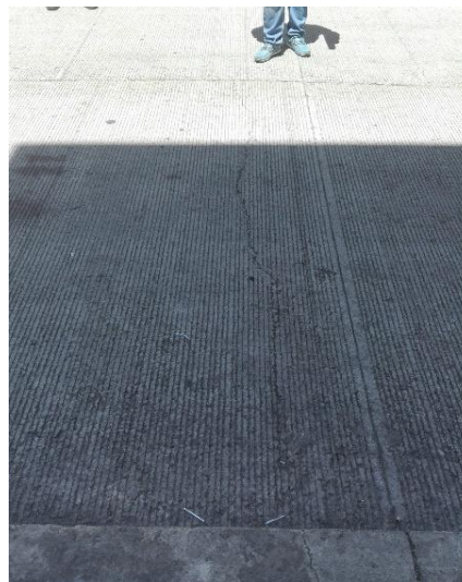
Rehabilitación Rígido Presenta fisura transversales en 1 losa.
