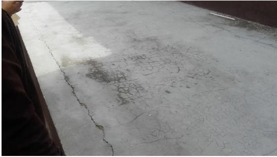
Foto N° 8-9 Fisuramiento placa costado oriental
