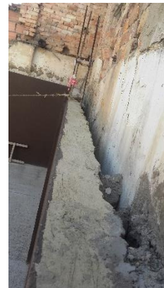
Foto N° 10-11 Filtración de agua entre muros colindantes
