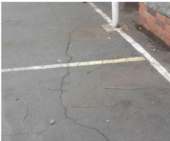
Foto 12: Fisuras en medialuna.
