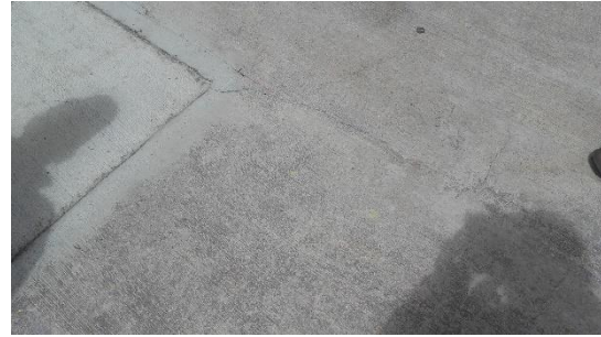
Fisuramiento placa costado occidental
